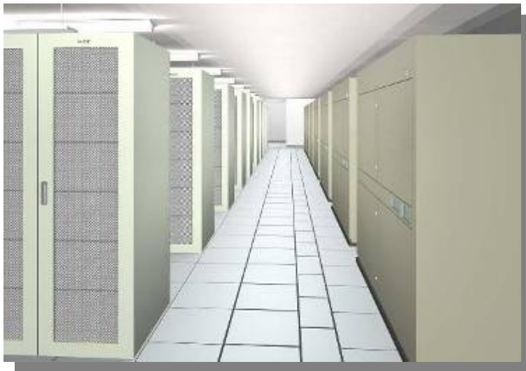
サーバールーム
